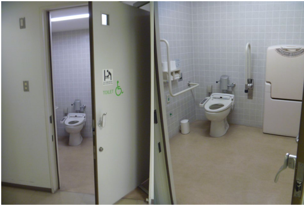
多目的トイレ 1階から6階
